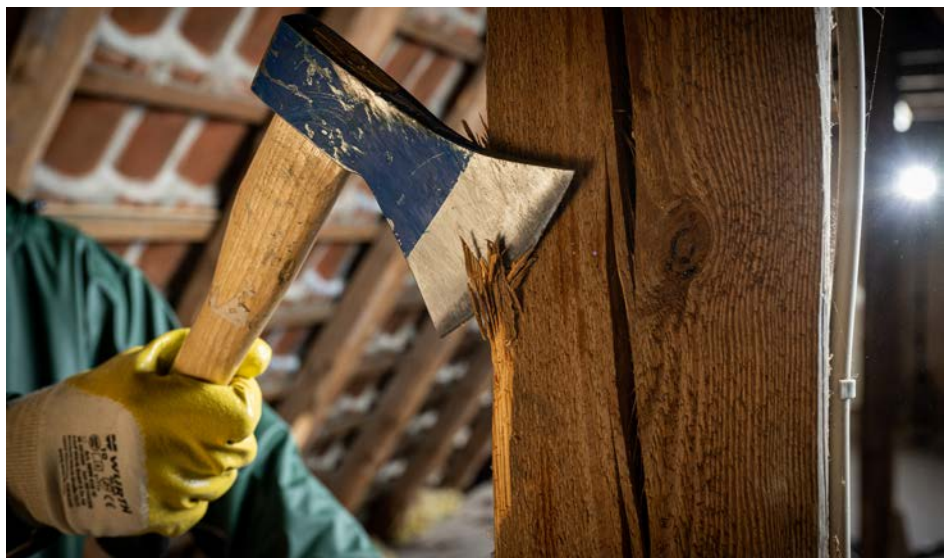
Bild 4: Abbeilen der befallenen Holzbauteile.
