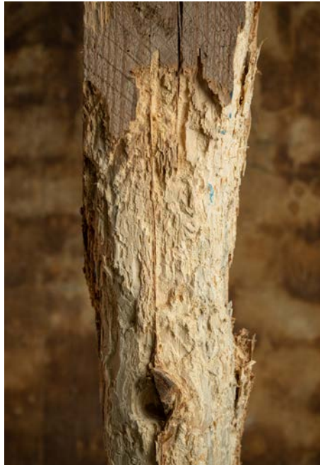
Bild 2: Durch die Larven des Hausbockkäfers stark geschädigtes Holzbauteil, das ausgebaut werden muss.
