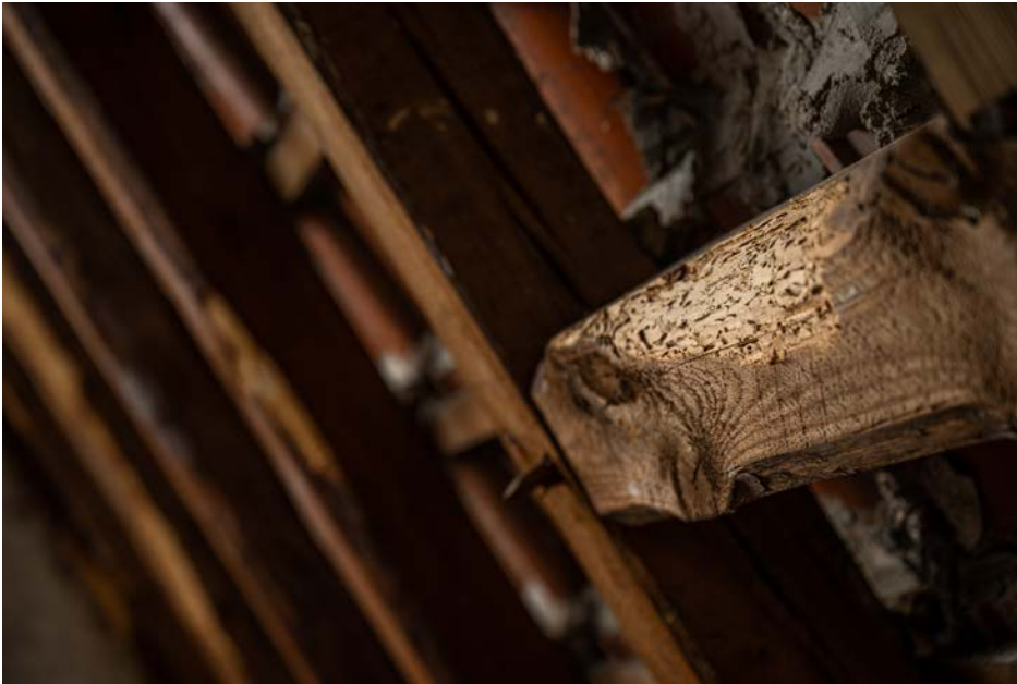
Bild 1: Durch Larven des Hausbockkäfers geschädigte Holzkonstruktion
