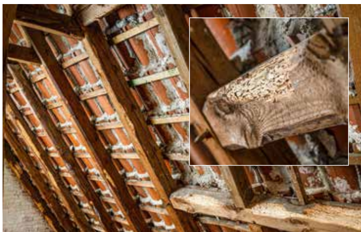
Geschädigte Holzkonstruktion durch Larven des Hausbockkäfers.
