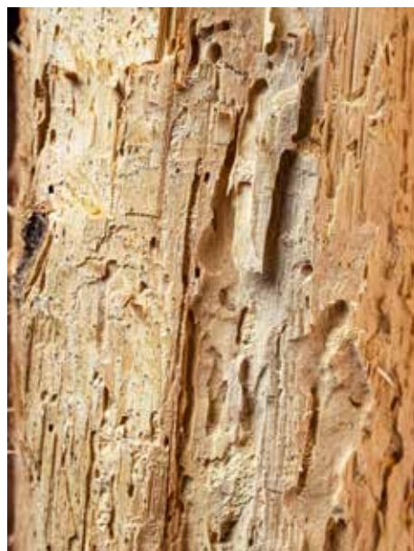
Fraßschäden am Splintholz verursacht durch die Larven des Hauseckkäfers.
