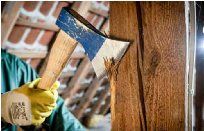
Abbeilen der befallenen Holzbauteile.
