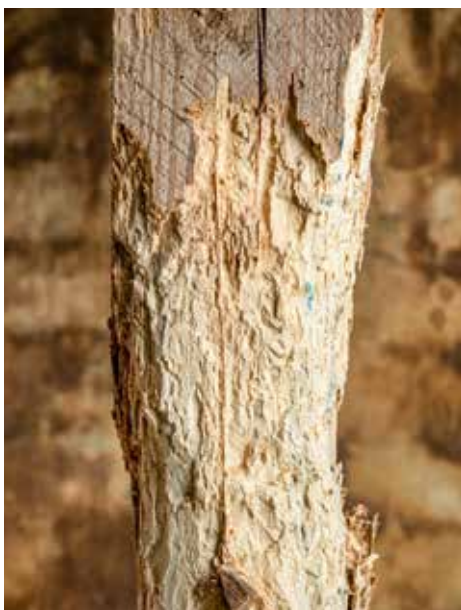
Durch die Larven des Hauseckkäfers stark geschädigtes Holzbauteil, das ausgebaut werden muss.
