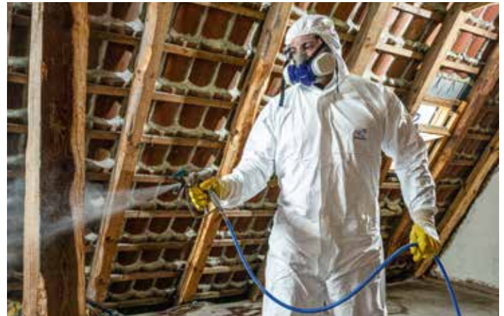
Das gelartige Holzschutzmittel Xilix Gel® wird mittels Airless-System auf das Holz aufgesprüht.
